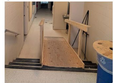
5) Non ADA Ramp in Corridor 146
