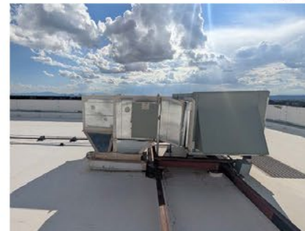
3) Roof Top Unit
